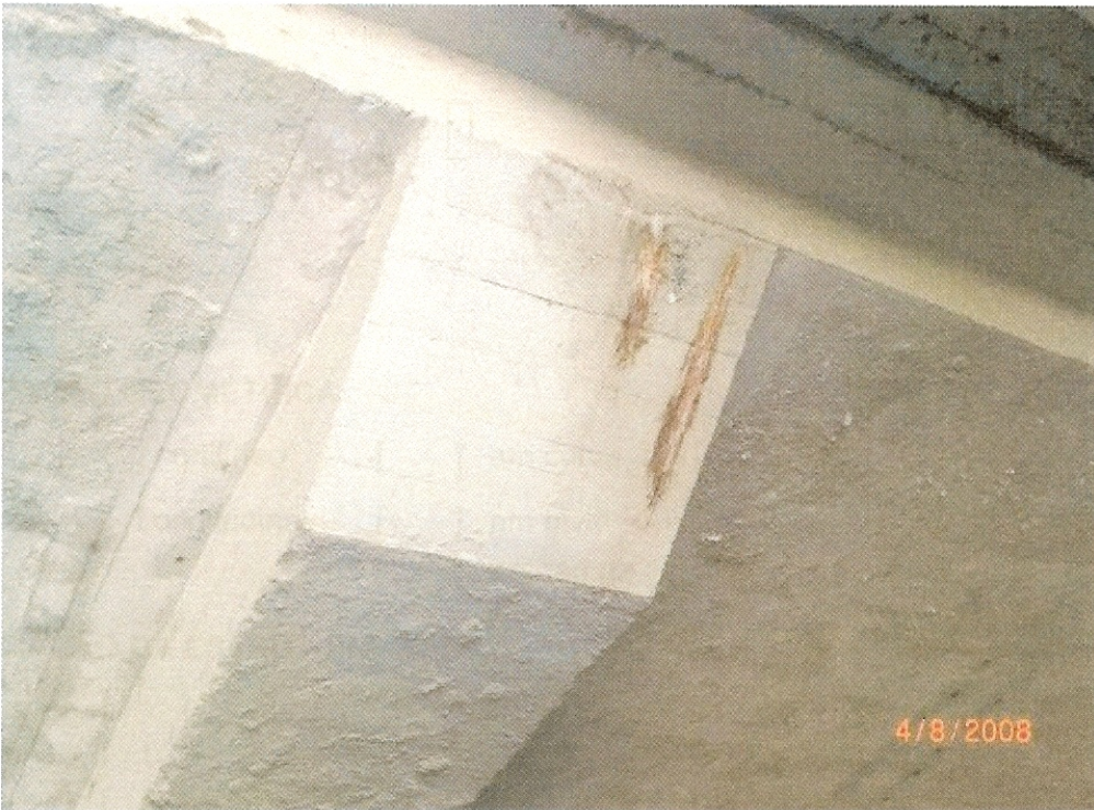
OBRA 04 SP 280 km 43+500 m – Vista de mancha de umidade na travessa
